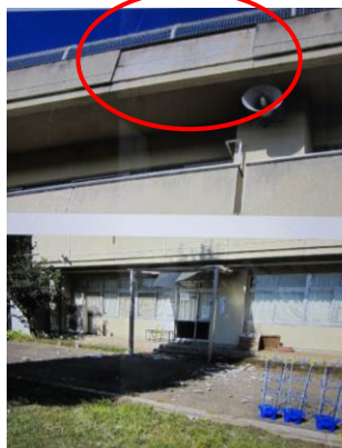
外壁が落下、久喜東小
